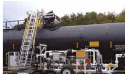
Plataforma de transbordo utilizada para transferir productos de vagones de ferrocarril directamente a camiones cisterna sin instalaciones de almacenamiento intermedio.
