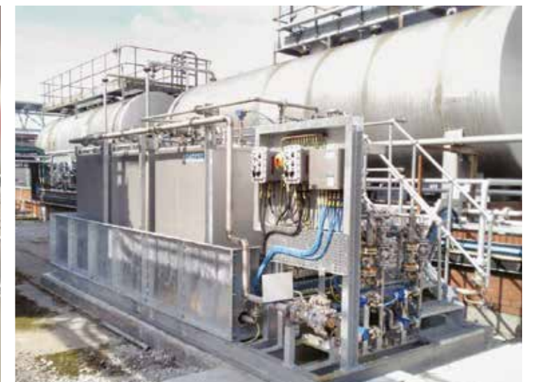
Plataforma de inyección de aditivos con dosificación de servicio y reserva - España - Industria de los combustibles
