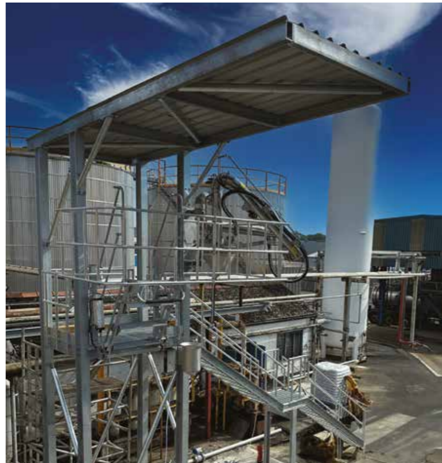
Plataforma de carga de cisternas con tejadillo y brazo de carga
